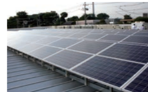
太陽光発電設備
