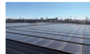
太陽光発電設備
